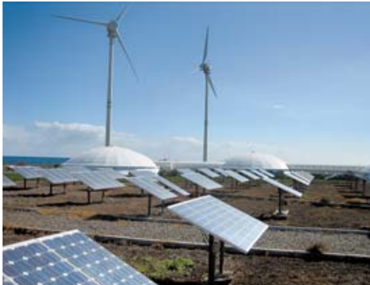
Instalaciones de desalinización con energías renovables del ITC en Gran Canaria.
